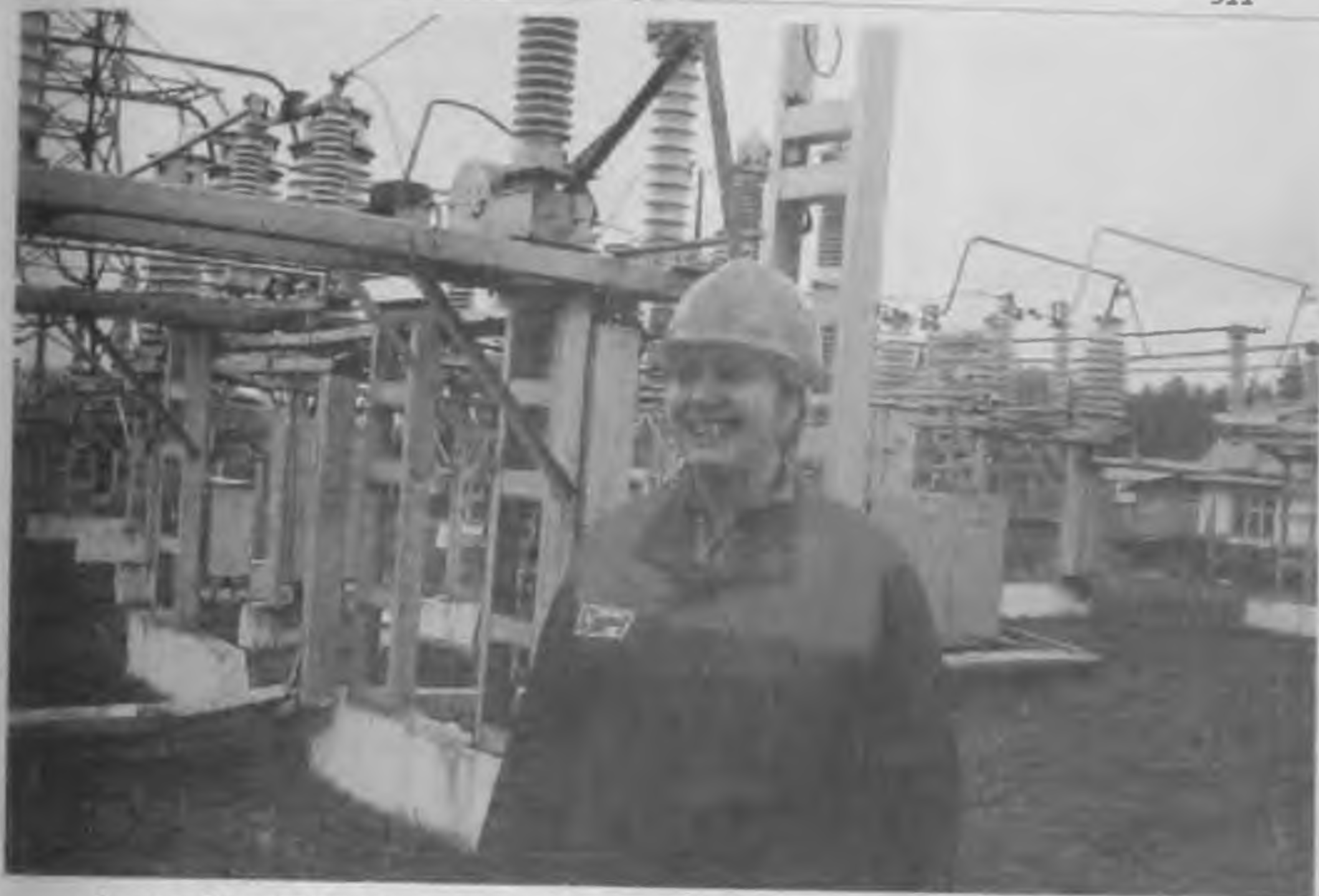
4 октября 2006 года пущена в эксплуатацию подстанция Турочакского РЭС (районных электросетей) Горно-Алтайских электросетей ОАО «Алтайэнерго»
